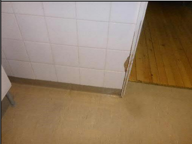
Kuva 63. WC- ja märkätilojen pinnoilla paikoin kaakelit rikkoontuneet kolhiintumisen seurauksena.
