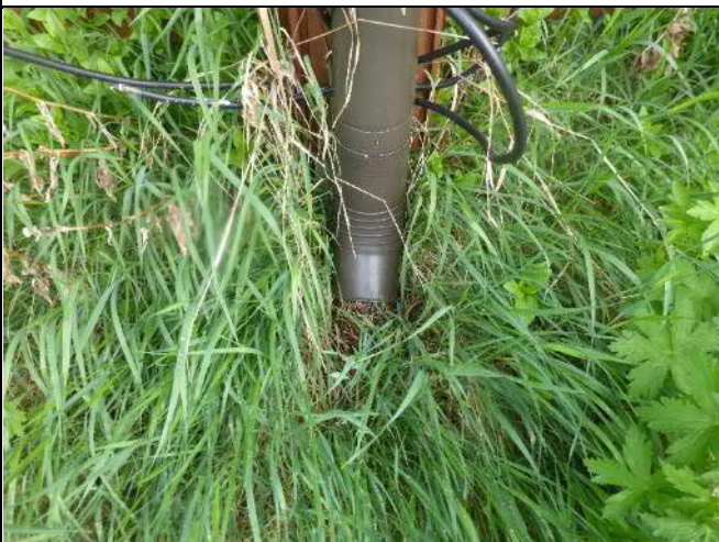
Kuva 5. Rakennuksen kaakkoispuolella syöksyputket ovat paikoin tukossa kasvustosta.
