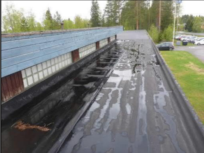
Kuva 43. Luoteispuolen katoksen vesikate. Katto on saatujen tietojen mukaan vuotanut. Syynä on todennäköisesti väärä katemateriaali.
