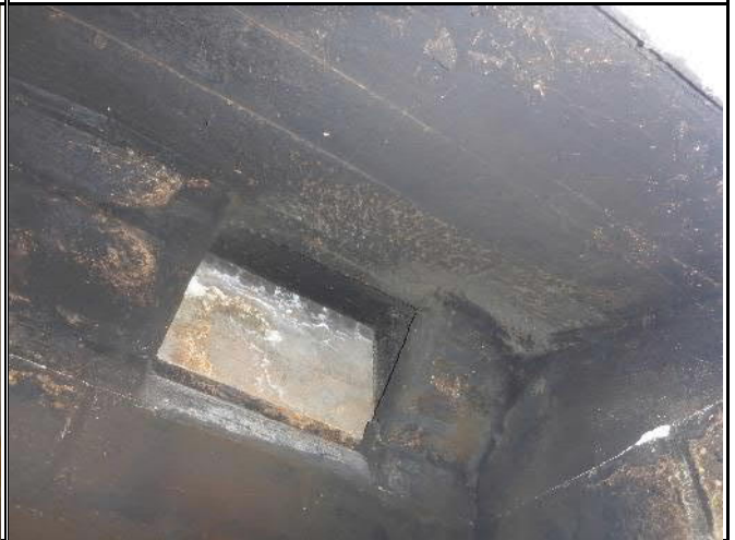
Kuva 76. Takan rakenteissa ei havaittu vaurioita. Kosteusjälkiä ha- vaittiin, joka mahdollisesti viittaa haitalliseen kosteuteen hormissa.
