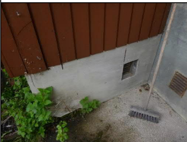
Kuva 11. Takapihalla betonisokkeli on peitetty sementtilevyllä ja todennäköisesti sokkelin ulkopinnassa on villaeriste. Peittävä rakenne heikentää betonisokkelin kuivumista.
