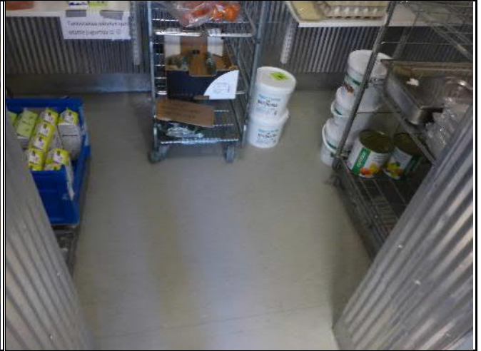
Kuva 56. Keittiön kylmiön lattian muovimattopinnoilla havaittiin korkeita pintakosteuksia
