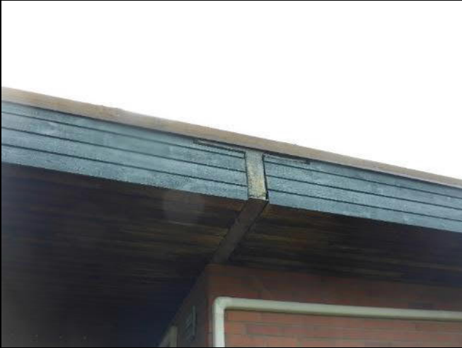
Kuva 19. Kantavat betonipalkit näkyvät räystään reunalta. Kuvan betonipalkki näyttää rapautuneen päästä.
