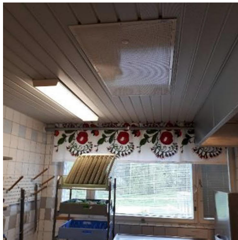
kuva: Keittiö tuloilma
