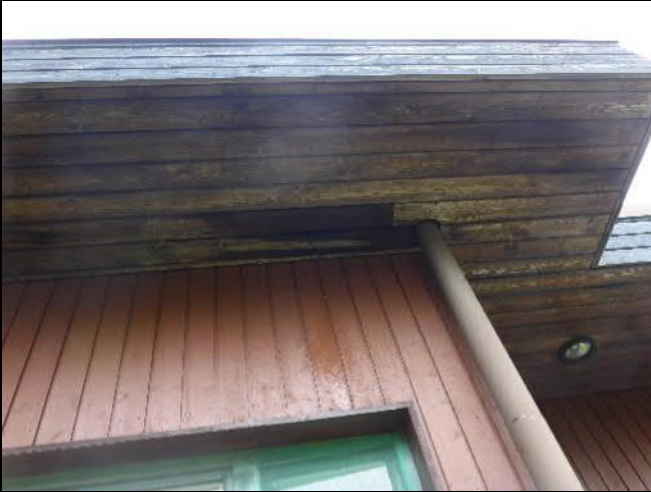
Kuva 25. Märkä seinärakenne takapihan puolella. Todennäköisesti räystäskourun ja syöksyn liitoskohdassa on vuoto.
