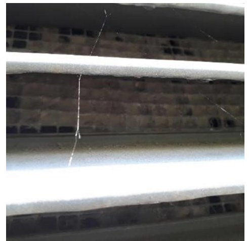
Kuva tukkeentunut ulkosäleikön ritilä.
