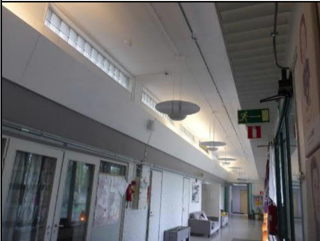
Kuva 57. Korotetussa eteisaulassa on koettu kylmää. Syynä voi olla isot ikkunat ja lasitiilipinnat kattokorotuksen kohdalla.
