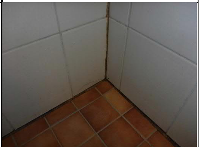
Kuva 60. Kylpyhuoneen rikkiönyt laatoitus suihkunurkassa. Rakenteessa mitattiin korkeita pintakosteuksia.
