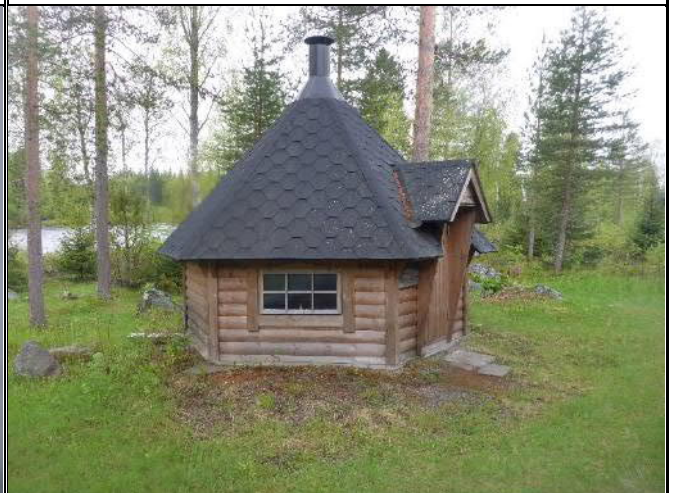
Kuva 10. Päärakennuksen kaakkoispuolella sijaitsee nuotiotupa. Tupa on kallellaan takana olevaa jokea kohti. Kunto muuten hyvä.
