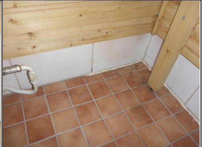
Kuva 62. Saunan kiukaan nurkassa seinän alaosassa kosteus on koholla ja kaakelipinnalla havaittiin halkeilua ja epätiiviyttä.
