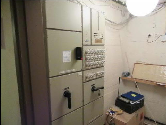
Kuva 1. Kiinteistön pääkeskus PK.
