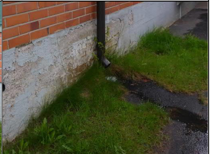
Kuva 4. Kohdassa on todennäköisesti aiemmin ollut vuotava syöksytorvi. Myös loiskekouru puuttuu syöksyn alta.
