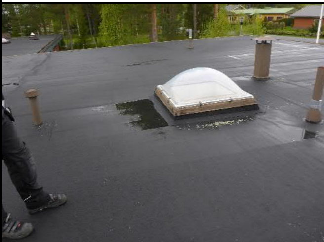
Kuva 47. Lammikoitumista kattopinnalla. Kermin saumakohtiin lammikoituminen aiheuttaa vuotoriskin.
