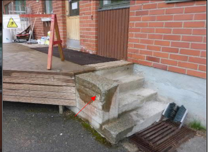
Kuva 32. Luoteispuolen terassille kulkevat portaat. pientä rapautumista mutta ei vaikuta käyttöön. Kaide puuttuu.
