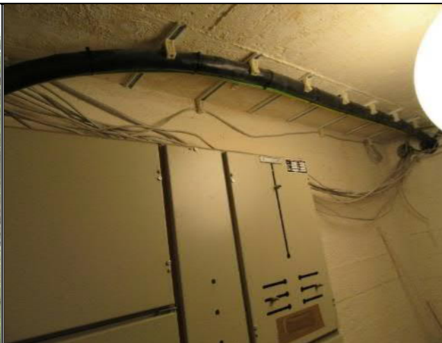
Kuva 14. Pääkeskushuoneessa HV-kaapeleita kiinnittämättä
