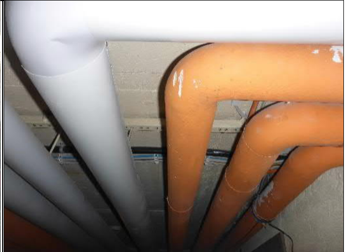
Kuva 68. Kellarin katossa on mahdollisesti asbestia sisältäviä putkieristeitä.
