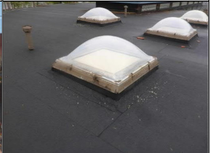
Kuva 46. Kattoikkunat. Vesikatteen ylösnostot tai saumat ovat saatujen tietojen mukaan vuotaneet usein lumien sulamisai-kaan.
