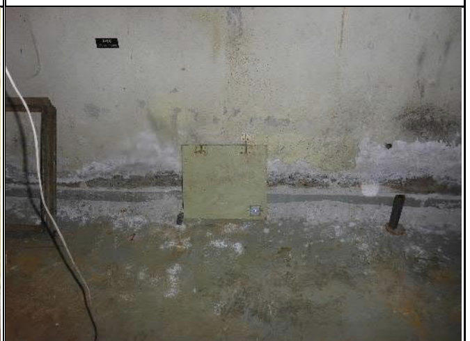
Kuva 72. Kellarin syvimmällä kohdalla, lämmönjakohuoneessa on runsaasti kosteusrasituksen jälkiä seinän alaosissa. Tila tulvii vuosittain.
