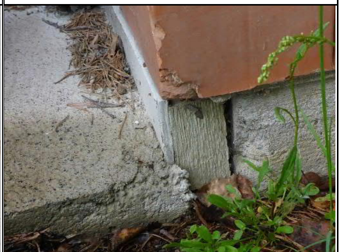
Kuva 12. Tarkempi kuva kevytrakenteisen perusmuurin rakenteesta. Levy saattaa sisältää asbestia.
