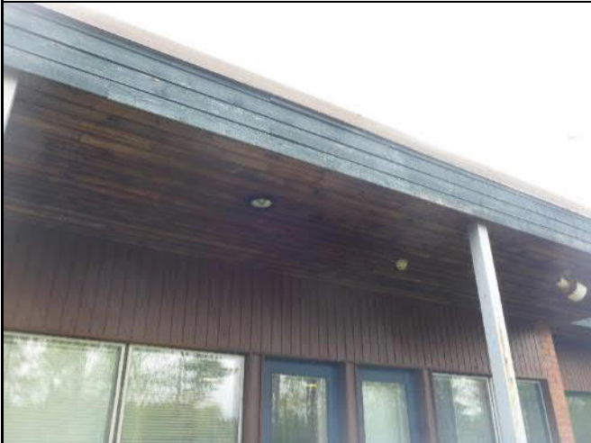
Kuva 39. Kaakkoispuolen katos. Värjäytymistä alalaidoituksessa mahdolliset vesivuotojen seurauksena.
