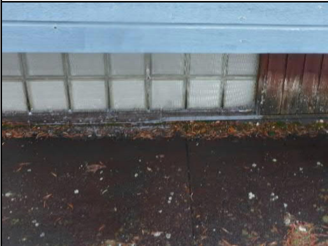
Kuva 45. Katon korotuksen viereen kertynyt sammalta ja ikkunat näyttävät epätiiviltä. Kosteusrasitus aiheuttaa rakenteeseen vaurioriskin.
