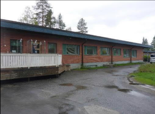
Kuva 1. Luoteispuolen pihan asfaltti pääsääntöisesti kohtalaisessa kunnossa. Lammikoitumista esiintyy paikoittain.
