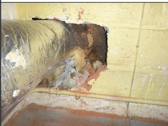
Kuva 71. Perusmuurin villaeriste (tiilimuurin takana) näkyvissä putkiläpiviennin kohdalla.
