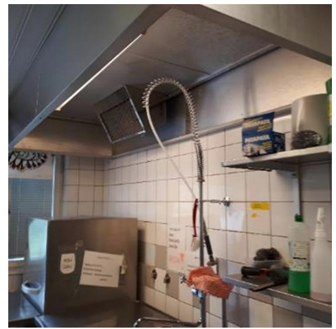
Kuva: keittiön huuvaloisto pesupaikalla
