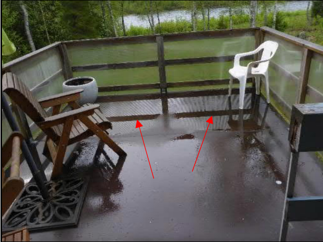
Kuva 37. Kaakkoispuolen terassi. Lammikoitumista ja selkeät painumat vanerin alla olevan poikittaispuun molemmin puolin.
