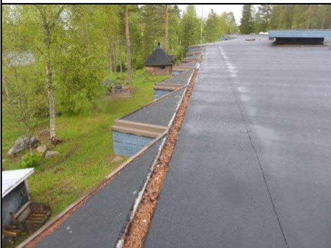
Kuva 41. Katon rännikourut huonossa kunnossa ja puhdistuksen tarpeessa. Ränneissä on todettu vuotoja ja niitä on paikattu.
