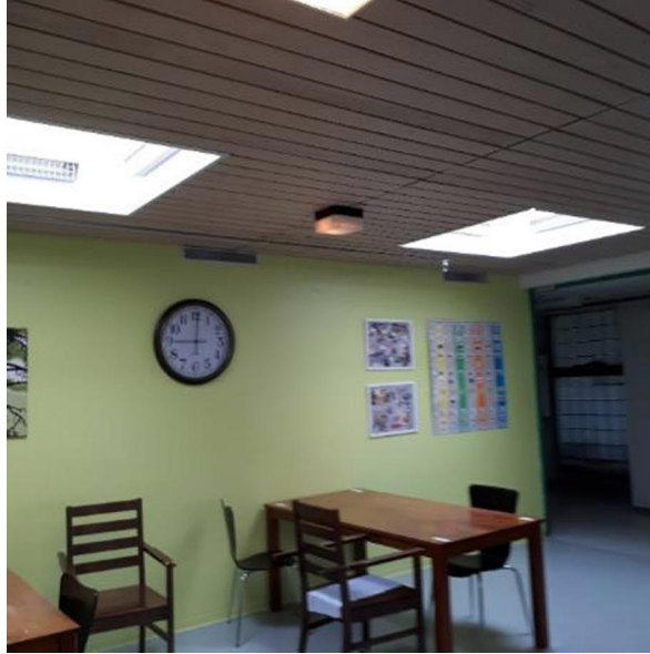
Kuva: Ruokailutilan ilmastointiventtiilit
