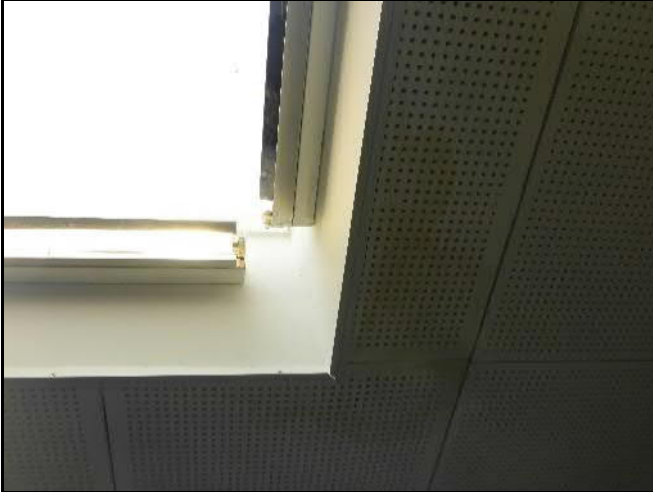
Kuva 49. Paikallinen vesivuotojälki kattoikkuna kohdalla. Rakenteessa voi olla kosteusvaurioita.
