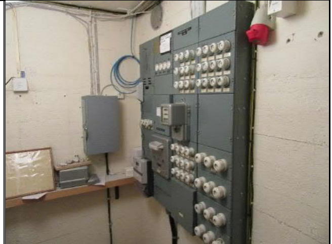
Kuva 2. Kiinteistön vanha pääkeskus PK (kiinteistössä kaksi pääkeskusta)
