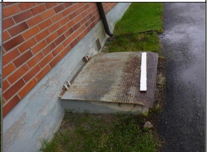
Kuva 18. Perusmuurissa oleva kellarinluukku on irronnut saroista, raollaan ja vääntynyt. Betonissa lohkeilua törmäyksen seurauksena.
