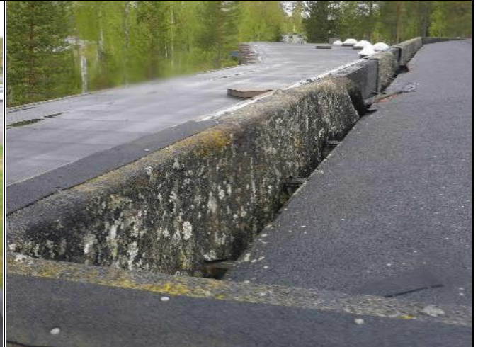
Kuva 44. Korotetulla katolla katekermit ovat irtoilleet ja ne eivät suojaa rakenteita.
