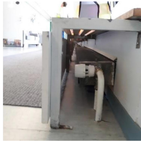
Kuvat: Lattian alla oleva konvektori hiekkatilassa oven edessä ja käytävällä ikkunan edessä
