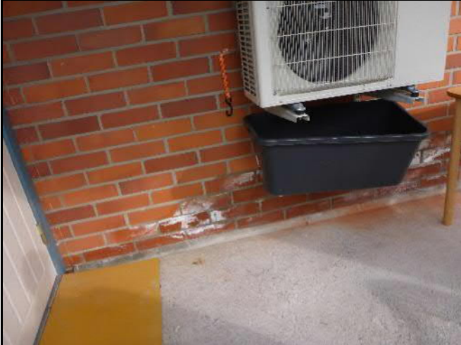
Kuva 7. Lämpöpumppujen kondenssivedet ovat aiheuttaneet haitallista kosteusrasitusta sokkeliin ja seinän alaosiin.
