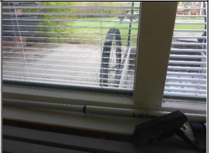
Kuva 58. Vanhojen ikkunoiden lämmöneristävyys voi olla heikko, joka aiheuttaa paikoin kylmää tiloissa.
