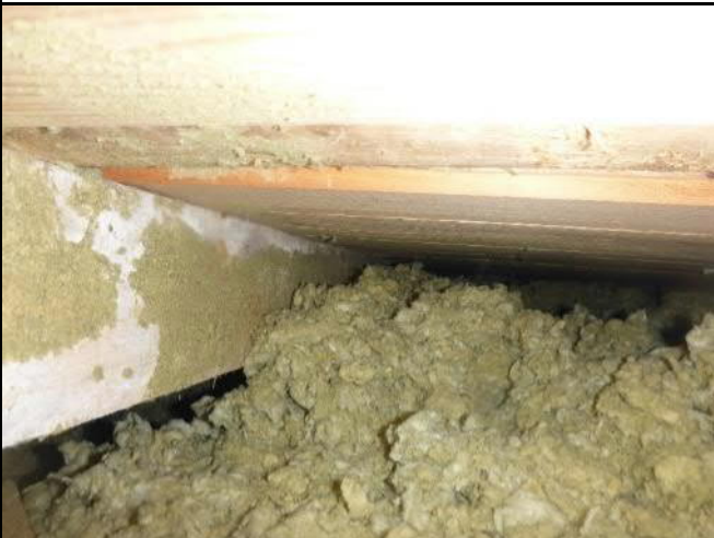
Kuva 21. Yläpohjan tuuletusrako on lähes ummessa. Tuuletus on puutteellinen tarkastuskohdissa.
