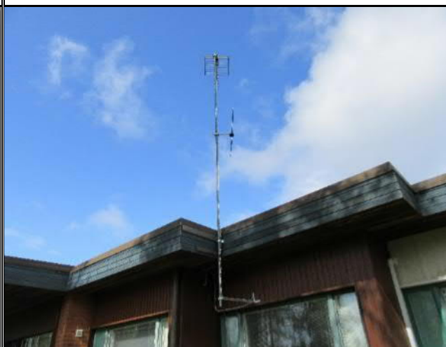
Kuva 16. Antenni takapihan seinällä
