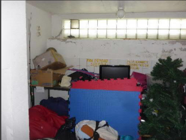
Kuva 67. Sokkeliosalla oleva lasitiili-ikkunan kohdalla havaittiin pinnoitevaurioita seinällä, joka voi viitata kosteusrasituksen aukon kohdalla.
