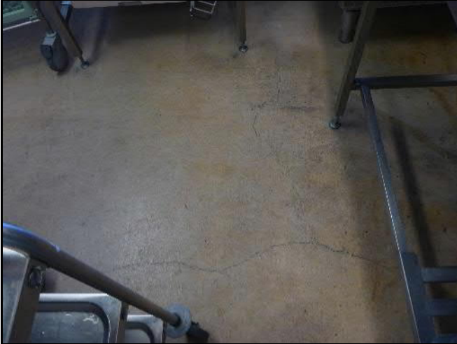
Kuva 55. Keittiön massalattiapinnoilla on runsaasti halkeilua. Pintakosteuksia ei kuitenkaan todettu.
