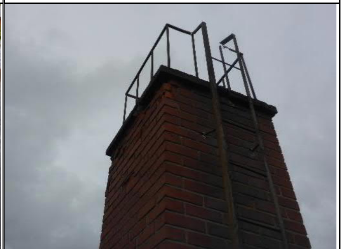
Kuva 48. Tiilipiipun tiilipinta on pahoin rapautunut. Tippuvat tiilipalat roskaavat kattoa.
