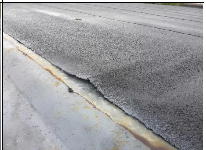
Kuva 42. Räystäskourun ja huopakatteen liittymät rakoilevat paikoin. Vuotoriski.
