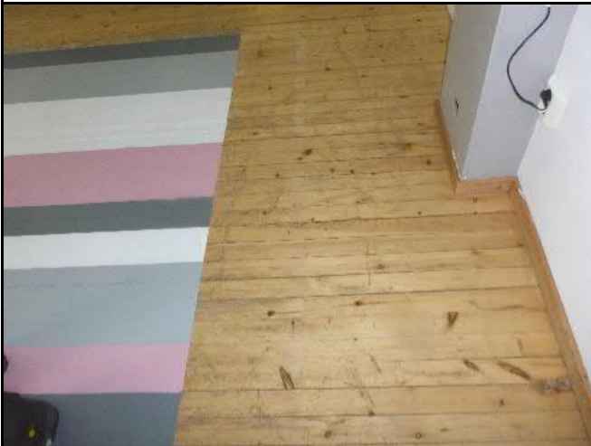
Kuva 51. Vanhan puulattian pinnalla paikoin runsaasti kolhuja/naarmuja.
