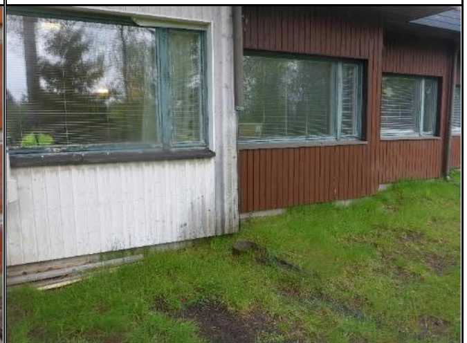
Kuva 24. Kevytrakenteinen ulkoseinä. Valkoinen seinä jäänyt korjauksessa pohjamaalille. Poikki oleva syöksytorvi kastellut seinää.
