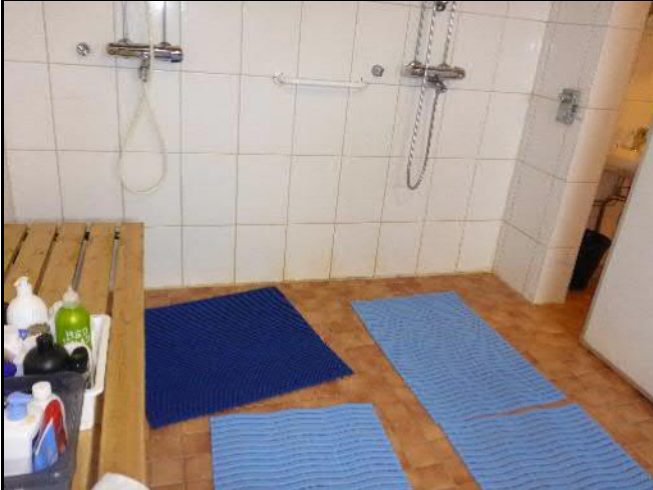
Kuva 61. Saunaosaston lattiakaakeloinneissa havaittiin laajoja irti olevia laattapintoja ("kopoja").
