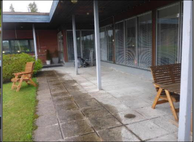
Kuva 38. Luoteispuolen katosalue. Katossa esiintynyt saatujen tietojen mukaan vuotoja.
