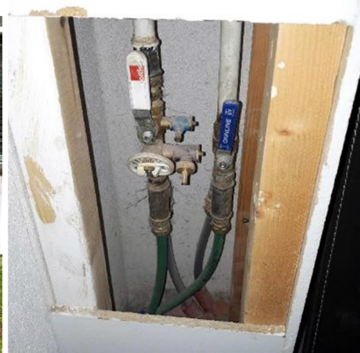
Kuva: sokkelilämmityksen säätöventtiili
