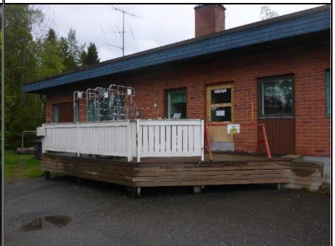
Kuva 36. Luoteispuolen terassi. Kunto hyvä. Kaide puuttuu portaiden vierestä.
