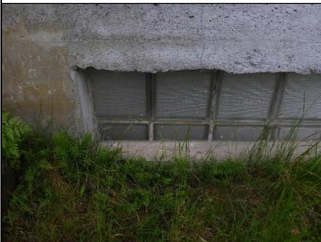
Kuva 17. Perusmuurissa sijaitsevien ikkunoiden pellitys puuttuu ja rakenne näyttää epätiiviiltä.
