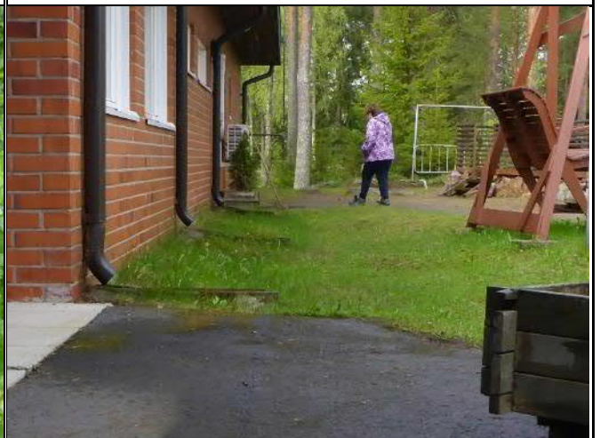
Kuva 6. Rakennuksen lounaispäädyssä maanpinnan korkeus on lähes lattiapinnan tasossa. Kosteusrasitusta syntyy seinän alaosiin.
