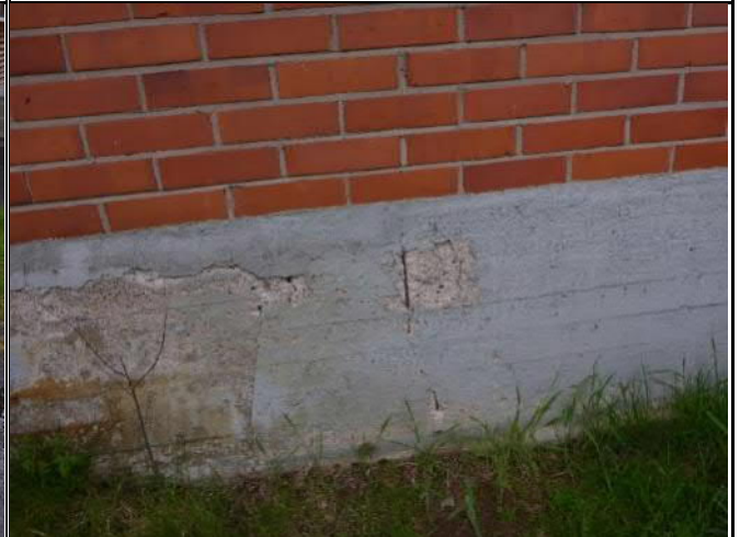
Kuva 16. Sokkelibetonipinnalla rapautumista kosteusrasituksen seurauksena. Yksittäinen ruostunut rauta näkyvissä.
