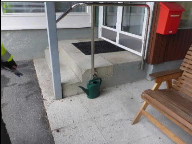
Kuva 33. Pääkulkureitillä sijaitsevat betoniportaavat. Kulmassa pieni lohkeama, mutta ei vaikuta käyttöön.
