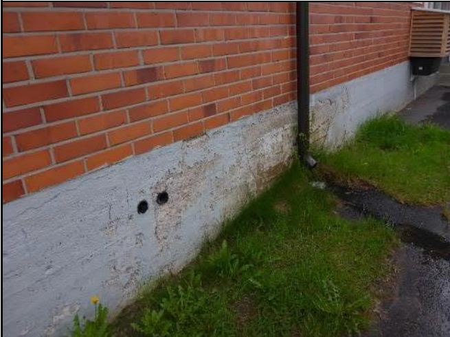
Kuva 15. Sokkelin maalipinta rapautunut. Syynä on todennäköisesti aiemmin vuotanut syöksytorvi.
