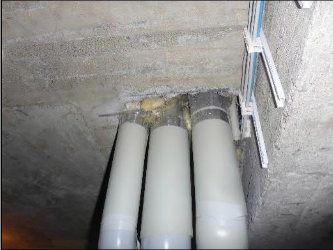
Kuva 73. Palokatkoa on puutteellinen kellarin ja 1-kerroksen putki- läpivientien kohdalla.
