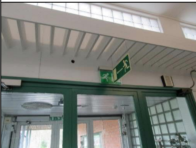
Kuva 11. Käytävän 71 ovimerkkivalaisin ja jälkiheijastava kilpi
