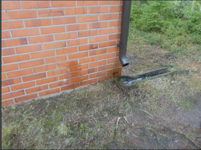
Kuva 13. Lounaispäädyssä sokkeli on matala ja kiinni maan pinnassa. Maakosteus pääsee siirtymään herkästi seinän alaosaan.
