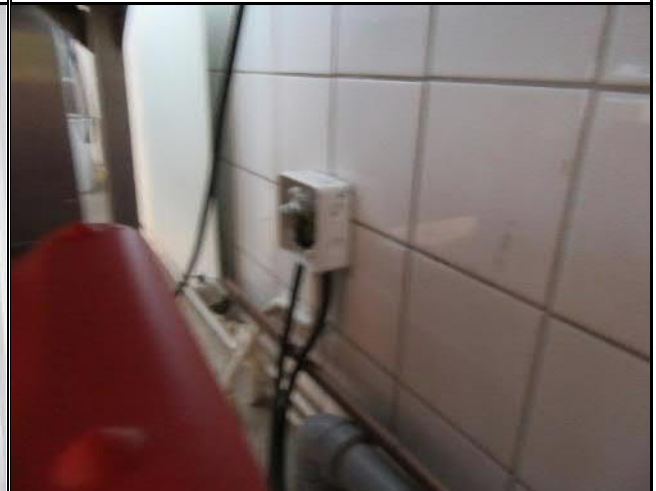
Kuva 4. Keittiön uunin jakorasialta kansi puuttuu
