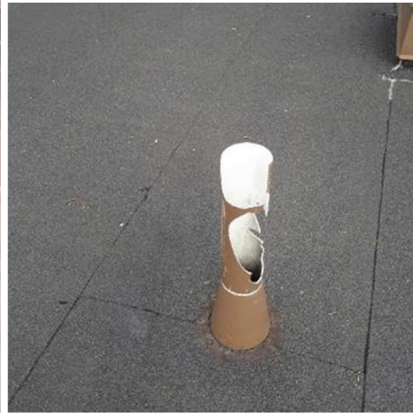
Kuva: rikkoontunut tuuletusputki
