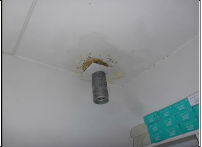
Kuva 50. Katon poistoilmahuuhtimen kohdalla on tapahtunut vesivuoto. Saatujen tietojen mukaan kohta on paikattu katolta.
