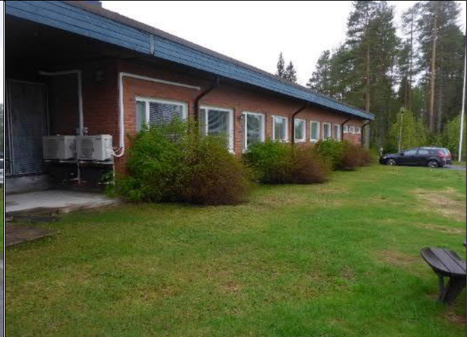
Kuva 2. Pensaita on paikoin rakennuksen vierustalla, joka aiheuttaa haitallista kosteusrasitusta rakennukseen.
