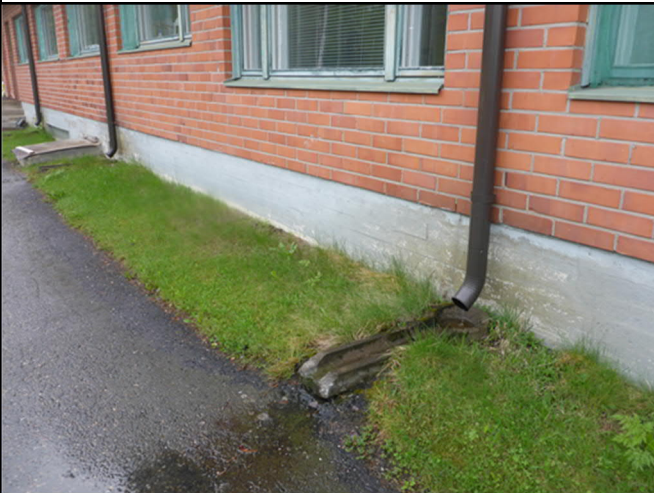
Kuva 3. Loiskekouru kaadot olivat puutteellisia. Roiskevedet ovat aiemmassa vaiheessa kastelleet sokkelipintaa.
