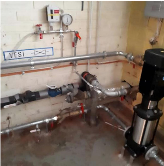
kuva: Sprinklausjärjestelmän paineenkorotuspumppu
