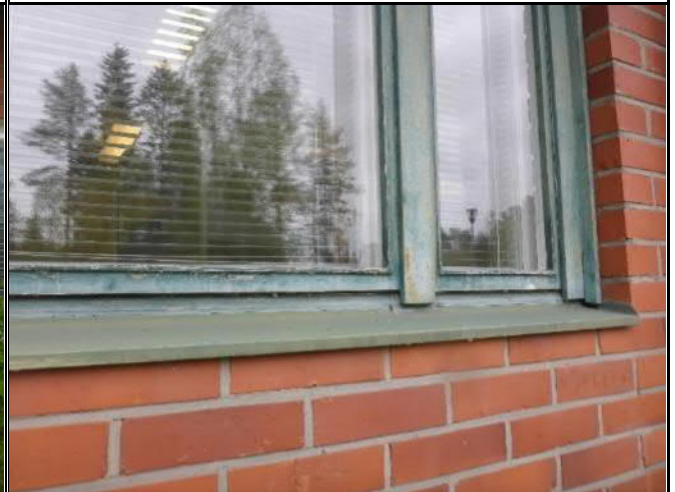
Kuva 28. Vanha puurakenteinen ikkuna. Maalipinnat ovat kuluneet.
