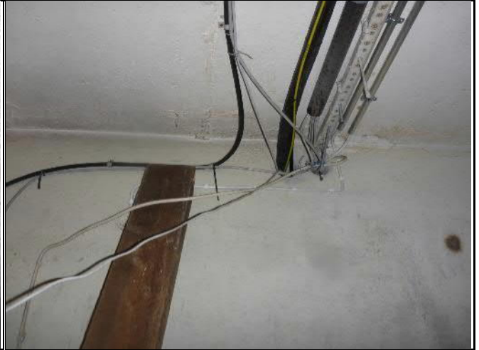
Kuva 74. Tiivistämätön johtoläpivienti kellarissa. Palo-osastointi tarkastettava.
