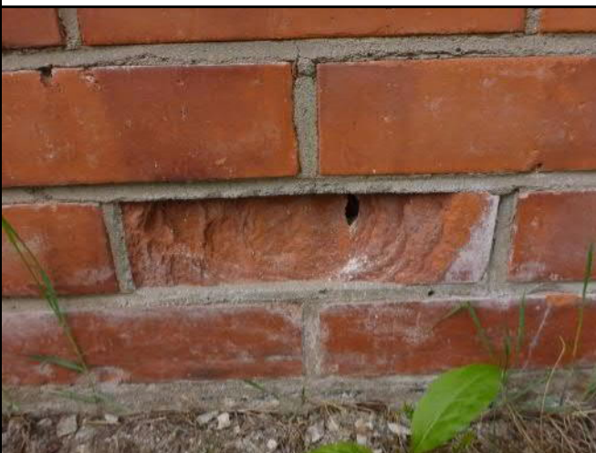
Kuva 23. Rapautunut tiili. Syynä todennäköisesti maakosteus ja matala sokkelirakenne.
