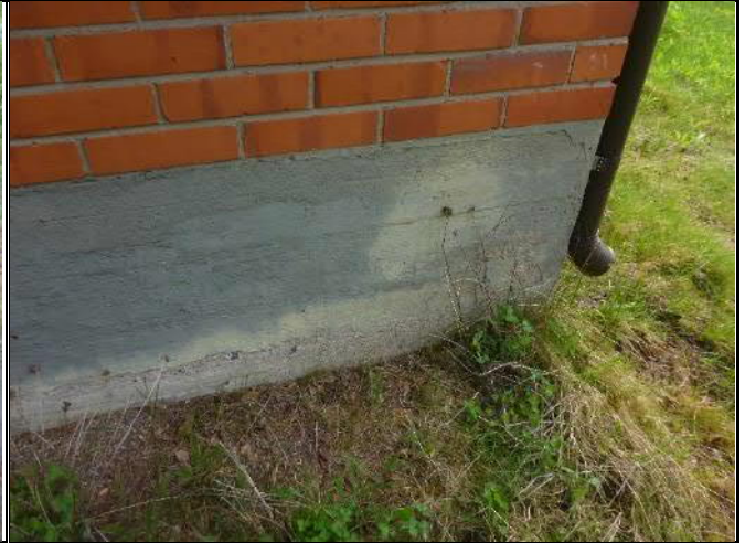
Kuva 14. Perusmuuri paikoin värjäytynyt ja maalikerros irronnut maasta nousseen kosteuden seurauksena.
