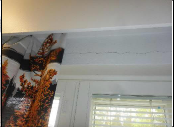
Kuva 26. Ikkunan yllä havaittiin paikallinen halkeama lounaispäädyssä. Rakenne oli luja koputeltaessa. Halkeaman kautta voi ilmavirtauksia tulla rakenteesta sisäilmaan.
