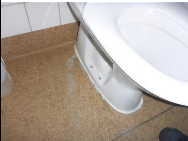
Kuva 65. Henkilökunnan taukotilan WC:ssä lattiamattopinnalla kohononnut kosteus ja matto irronnut kiinnityksestä.
