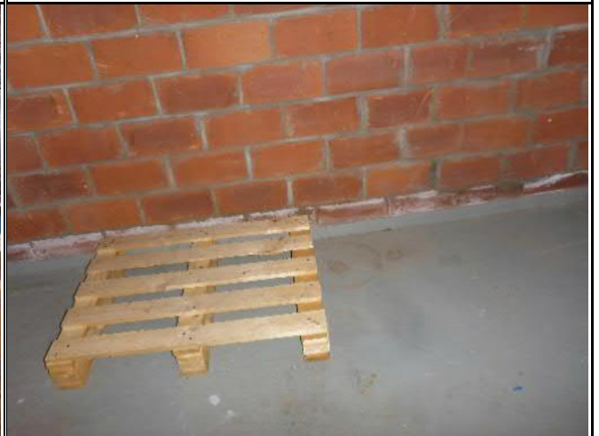
Kuva 70. Ylemmän kellarin maanvastaisen seinän alaosissa kosteuden aiheuttamaa kalkkihärmää. Lattia on joskus tulvinut.
