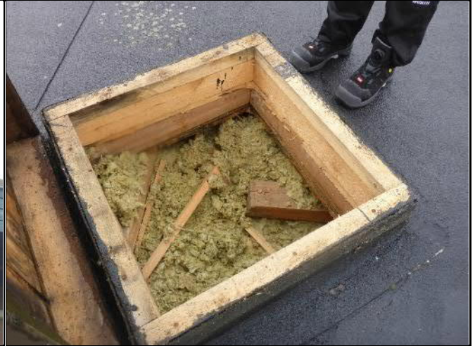
Kuva 20. Katon tarkastusluukusta näkee, että katon tuuletusväli on täytetty liian täyteen.
